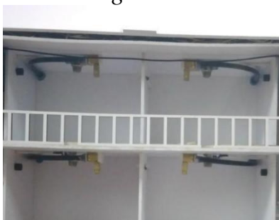
Hình 6: Đường ống dẫn nước chữa cháy
